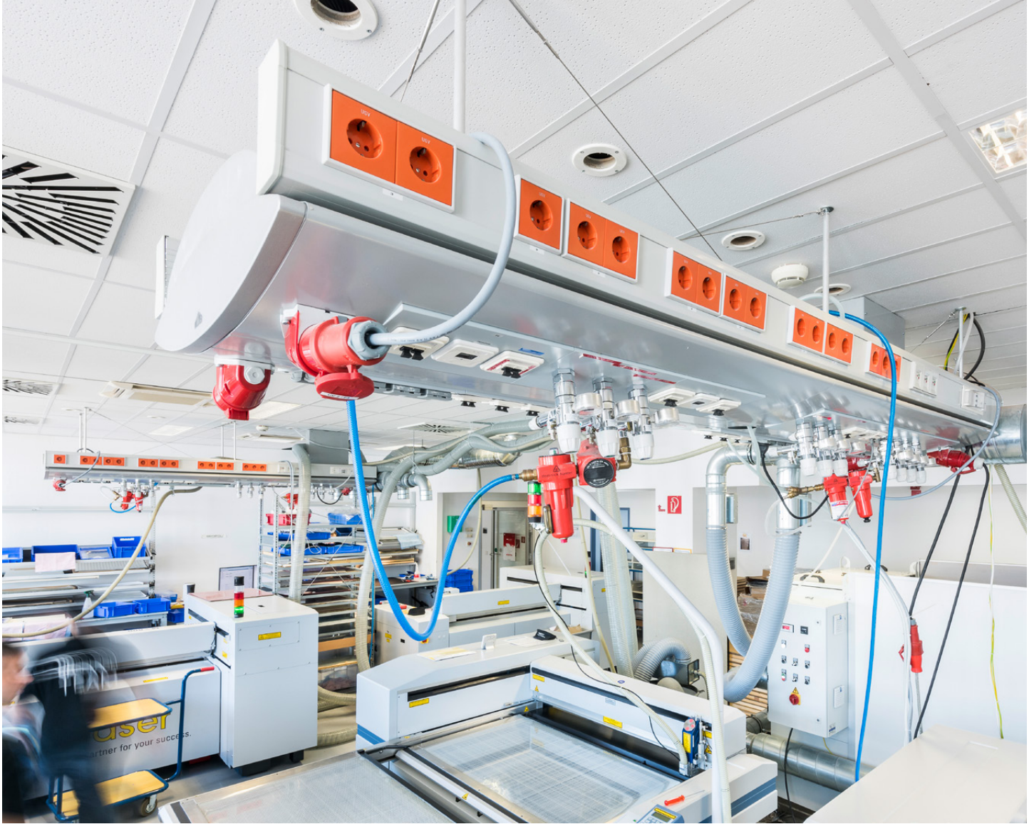
Produktionsflächen in „The Plant“ Konstanz Light manufacturing space in „The Plant“ Constance
